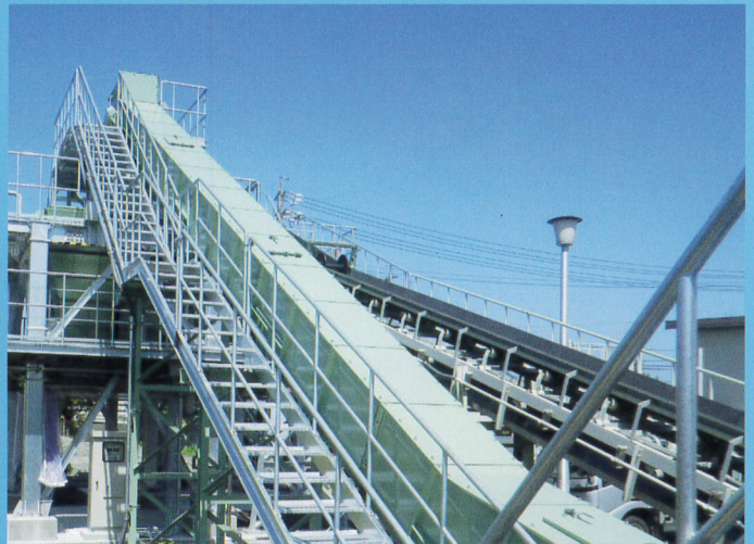
No.4沈砂搬出機
