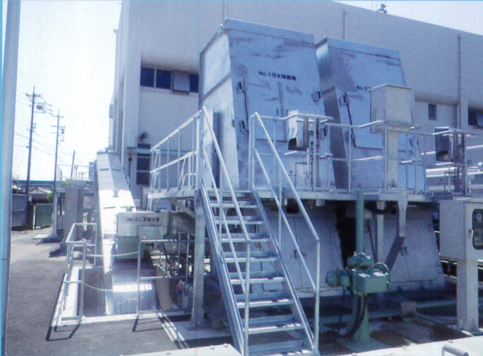
No.1.2汚水除塵機
