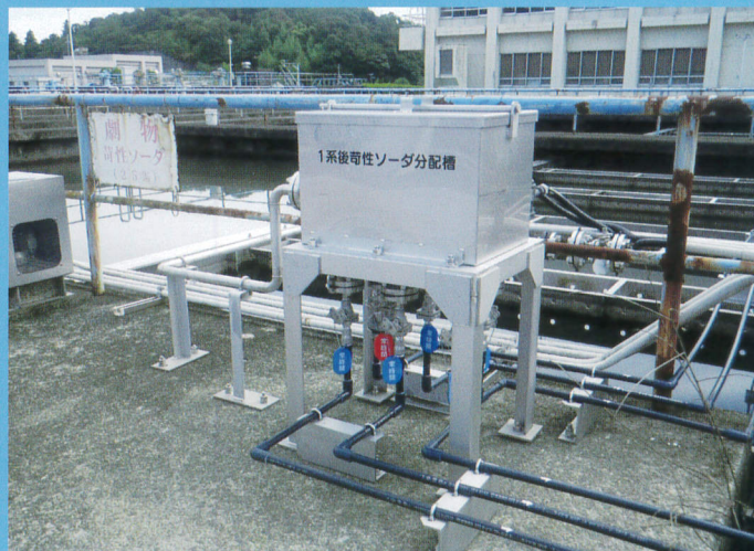
後苛性ソーダ分配槽
