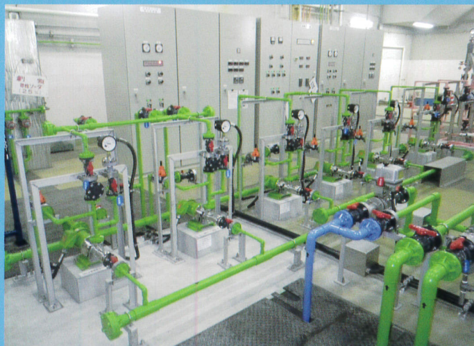
苛性ソーダ注入ポンプ
