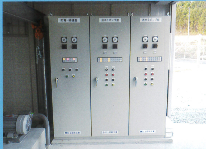
受電・補機盤 ポンプ制御盤 2面
