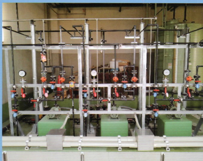
1～3号次亜塩注入ポンプ
