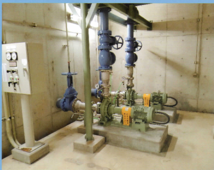
1、2号ろ過水移送ポンプ
