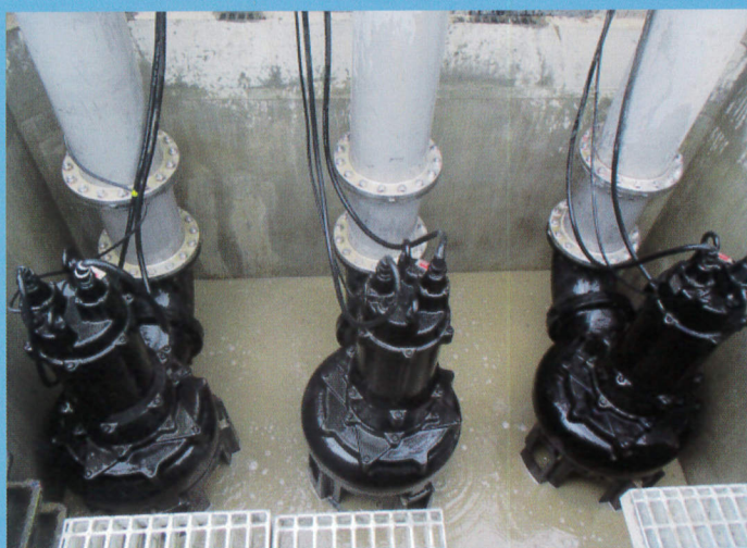
排水ポンプ300A 3台 （四日市JCT調整池A）
