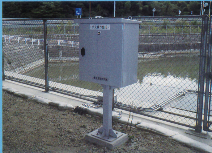
電動ゲート制御盤（東員IC 調整池）
