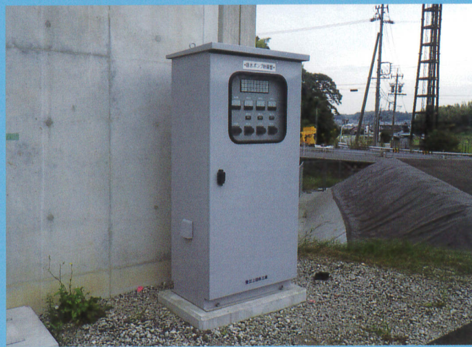
排水ポンプ制御盤（四日市JCT調整池A）
