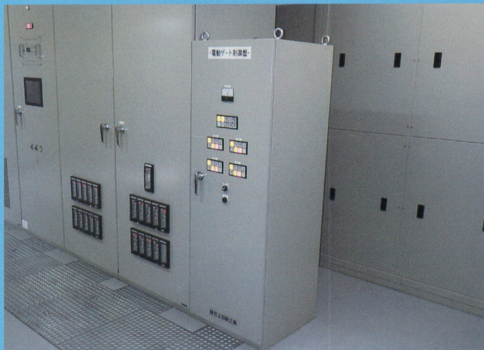
電動ゲート制御盤（東員IC 電気室内）
