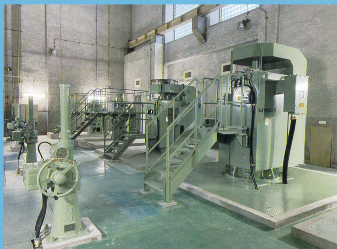
No.31主ポンプ用電動機
