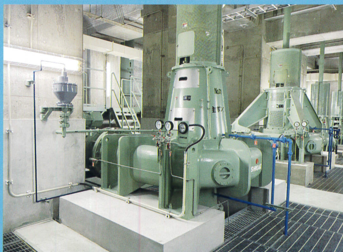
No.31主ポンプ
