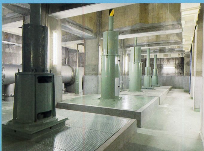
No.31主ポンプ中間軸受
