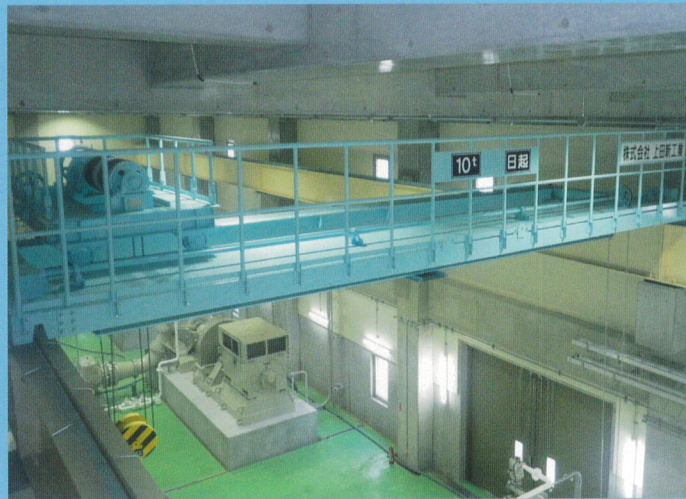
10 t 吊天井クレーン
