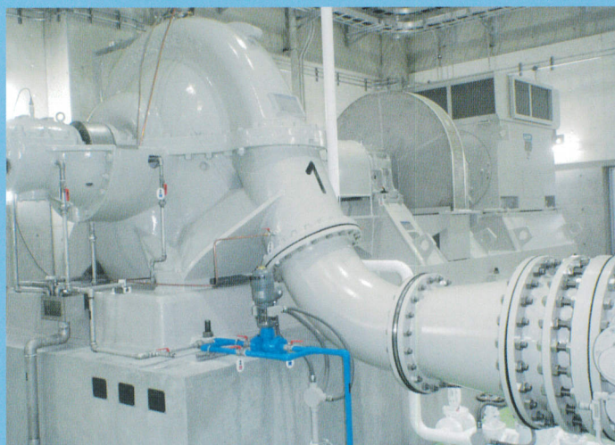
導水ポンプ 5台
