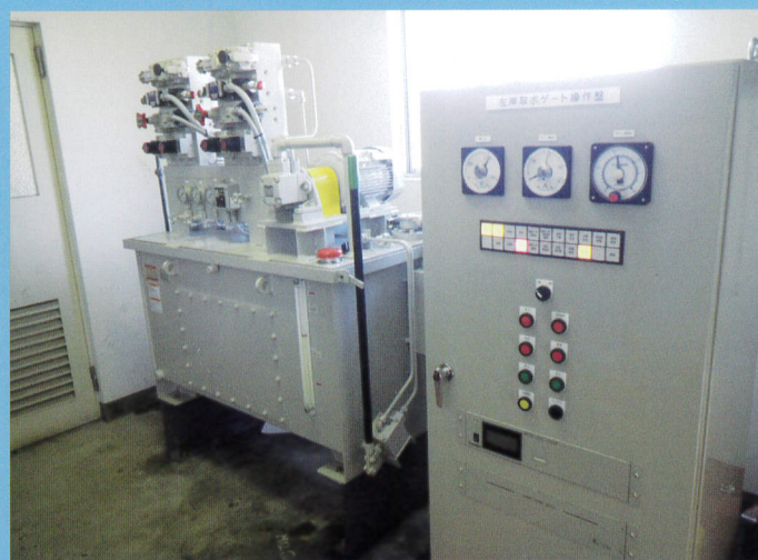
主ゲート操作盤
