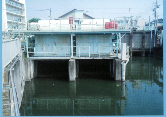
自動除塵機 水路幅 3,900 \times 高さ 2,800
