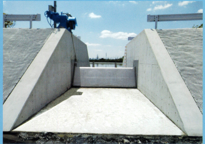
野田調整池(1号箇所) SUS製自動転倒ゲート
