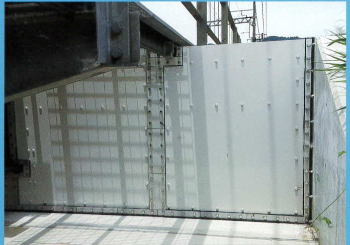
伊賀鉄道第2陸閘 防水板
