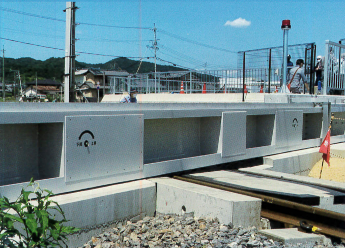
伊賀鉄道第1陸閘 横引ゲート設置状態
