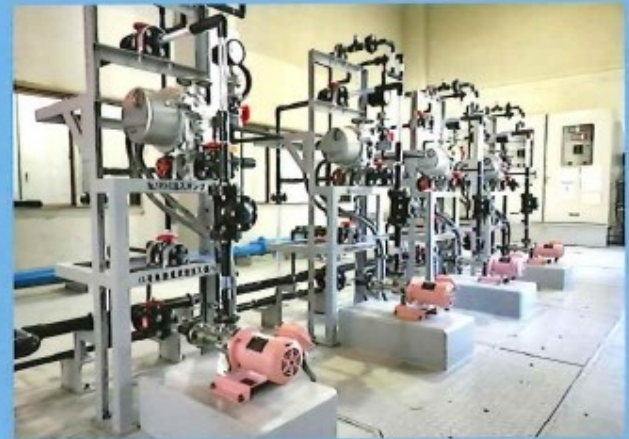
No.1～4PAC注入ポンプ
