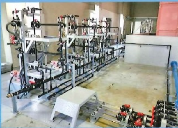
No.1～4PAC注入配管
