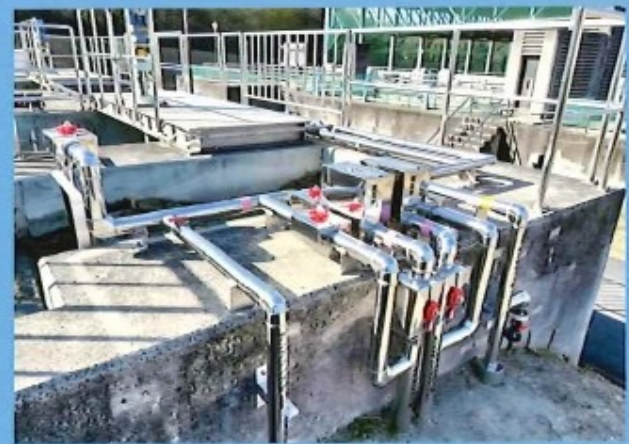
PAC注入配管
