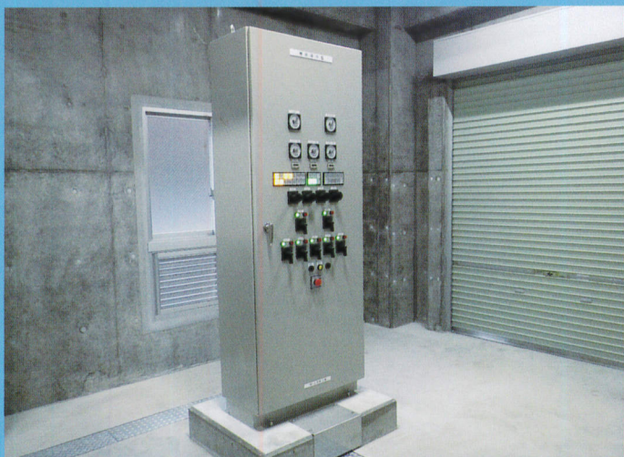
機側操作盤(中在家ポンプ室)
