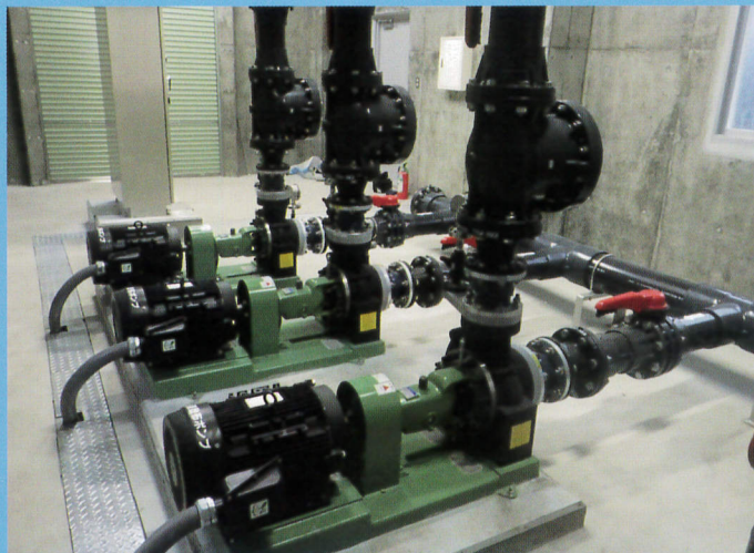
薬液散布ポンプ(中在家ポンプ室)
