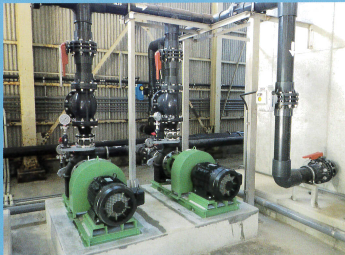
薬液攪拌ポンプ(加太基地ポンプ室)
