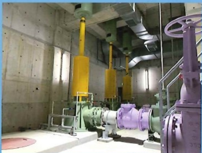
北系3号二次処理水揚水ポンプ
