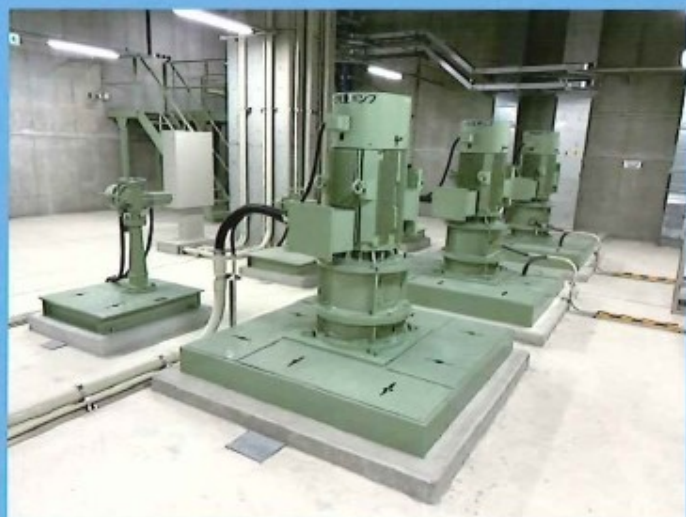
1-3号主ポンプ電動機
