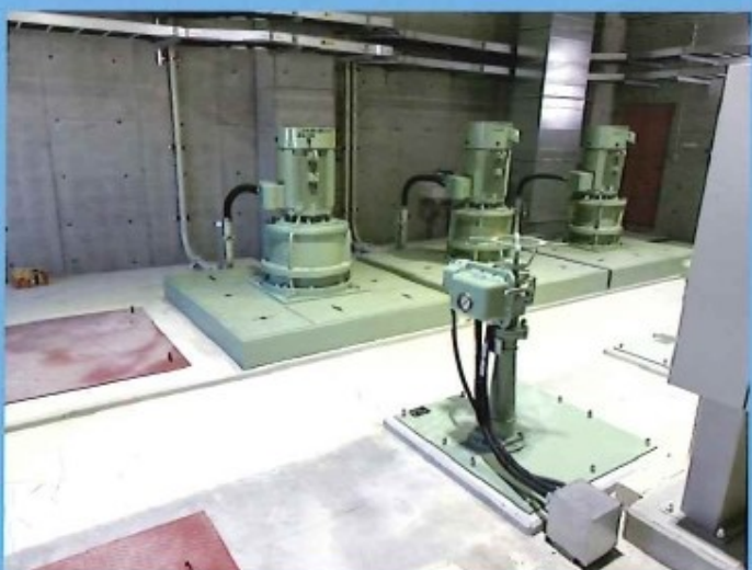
北系3号二次処理水揚水ポンプ電動機
