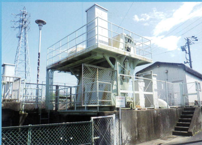
自動除塵機 更新前
