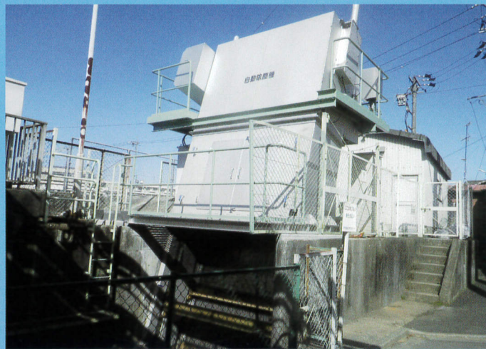
自動除塵機 更新後
