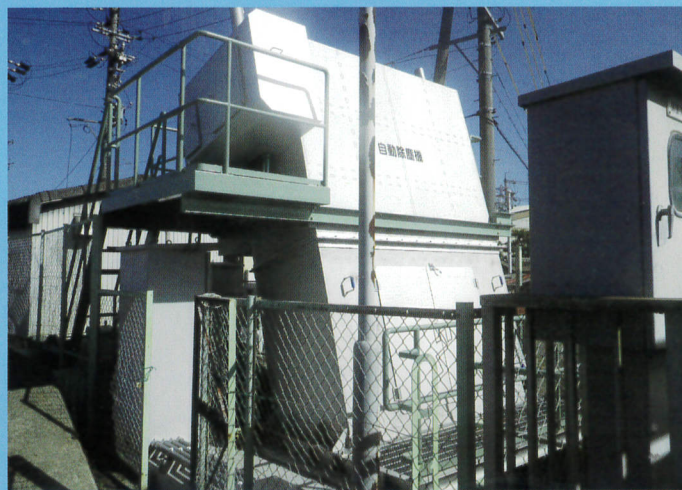
自動除塵機 更新後
