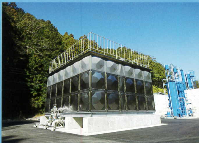
桐原浄水場 ステンレスパネルタンク配水池
