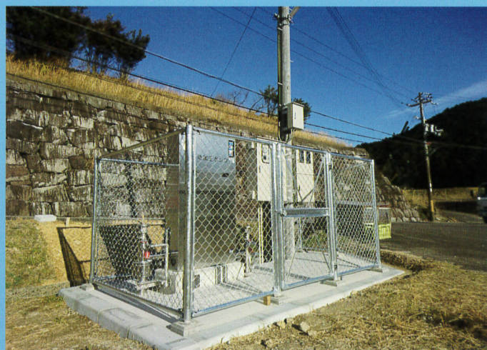
加圧ポンプ場
