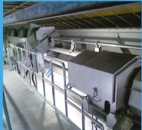
除塵機点検歩廊上部
