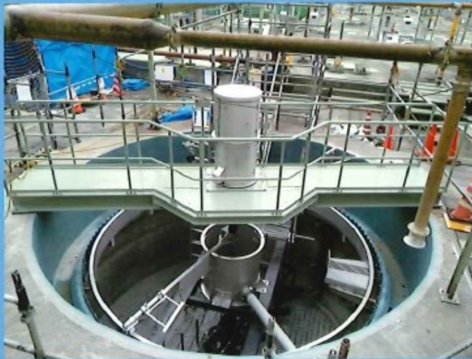
濃縮汚泥掻寄機(下部)
