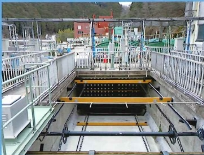
終沈汚泥掻寄機(上流側)
