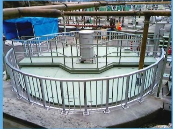
濃縮汚泥掻寄機(上部)
