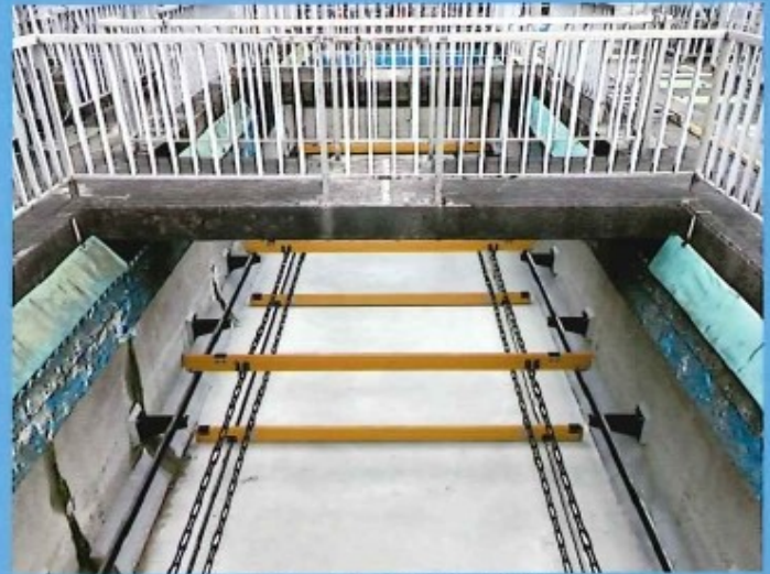
終沈汚泥掻寄機(下流側)
