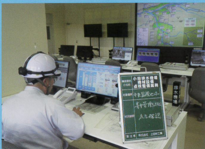
小田排水機場 集中管理システム表示確認
