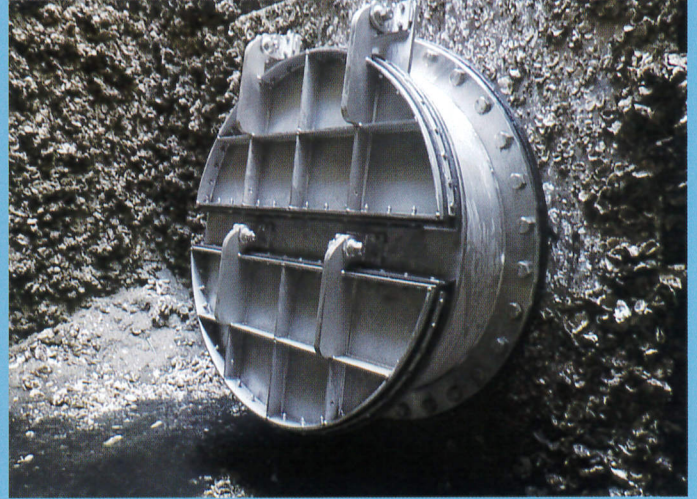
No.1雨水ポンプ用逆流防止弁(完成)
