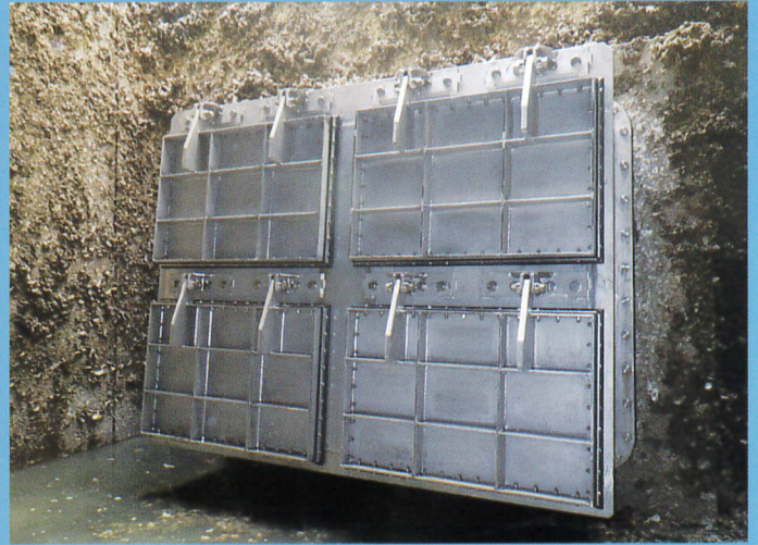
No.4雨水ポンプ用逆流防止弁(完成)
