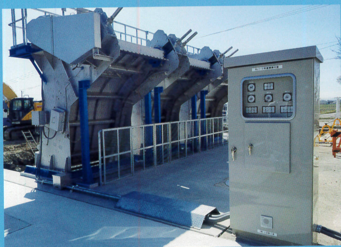
【新設】No.1～3除塵機操作盤
