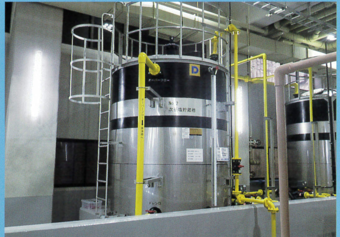
No.2次亜塩貯蔵槽
