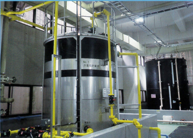
No.1次亜塩貯蔵槽
