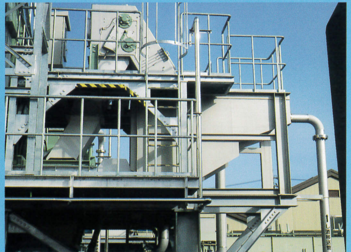
汚水しき分離機(スクリーンユニット)
