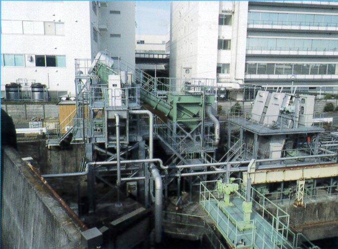
汚水沈砂池設備 全景
